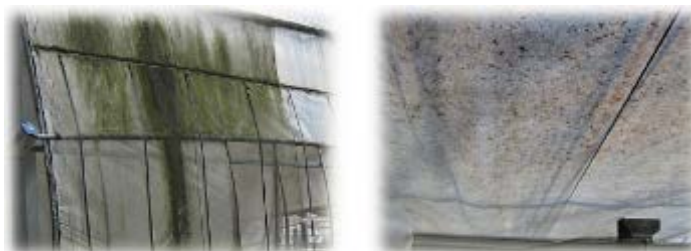
汚れが付着した被覆資材の例
