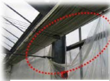
肩部の垂れ下がりによる隙間
