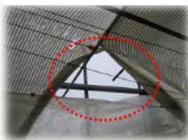
天井カーテンの隙間 (表面)
