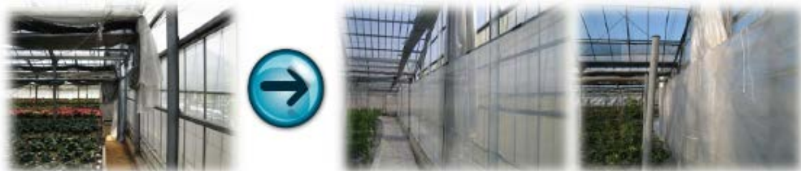
妻面カーテンの隙間
