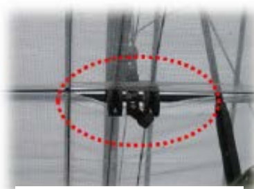
天井の滑車付近の隙間
